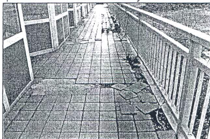
poškodená dlažba na terase
