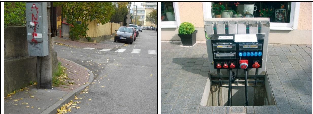
obr.: Reprezentatívny príklad umiestnenia verejného technického vybavenia v križovatke ulíc Jakubíkova a Jahodová, obmedzujúci pešiu dopravu.
